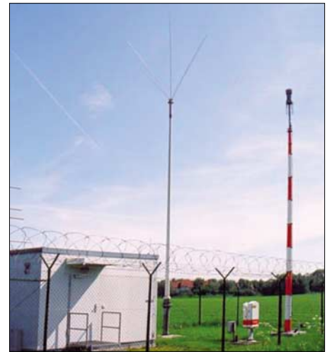
Sendecontainer und Antennenanlage der NDB ERT
